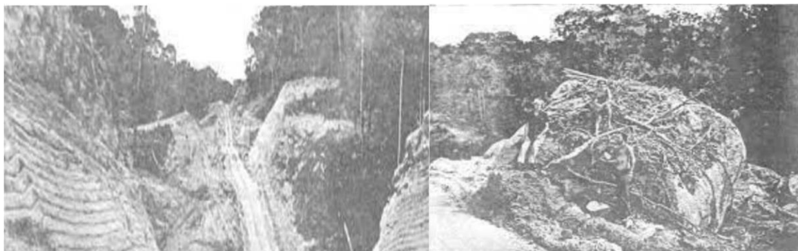
Figura 3 – Fotografias ilustrando os desafios e falta de planejamento para abertura da Rodovia Transamazônica em 1970
