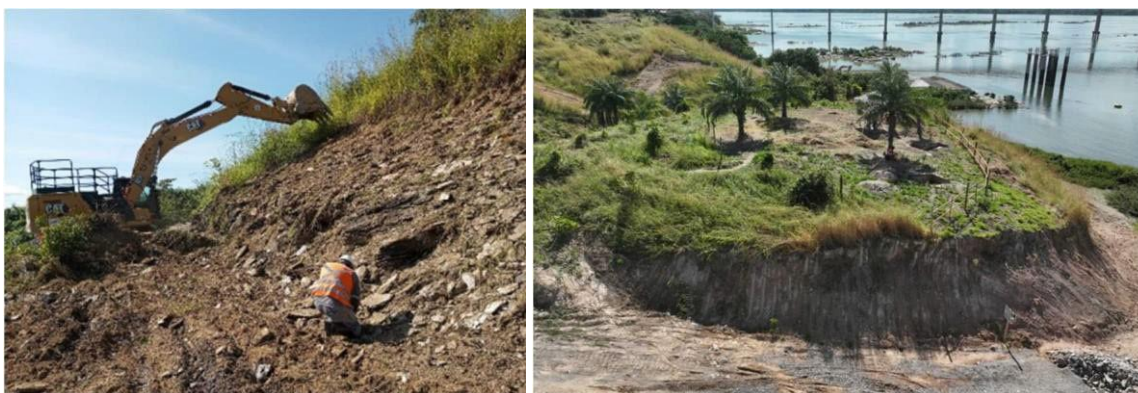
Figuras 47 e 48 – Localização da área 04 e raspagem mecanizada do talude com acompanhamento contínuo da equipe de arqueologia
