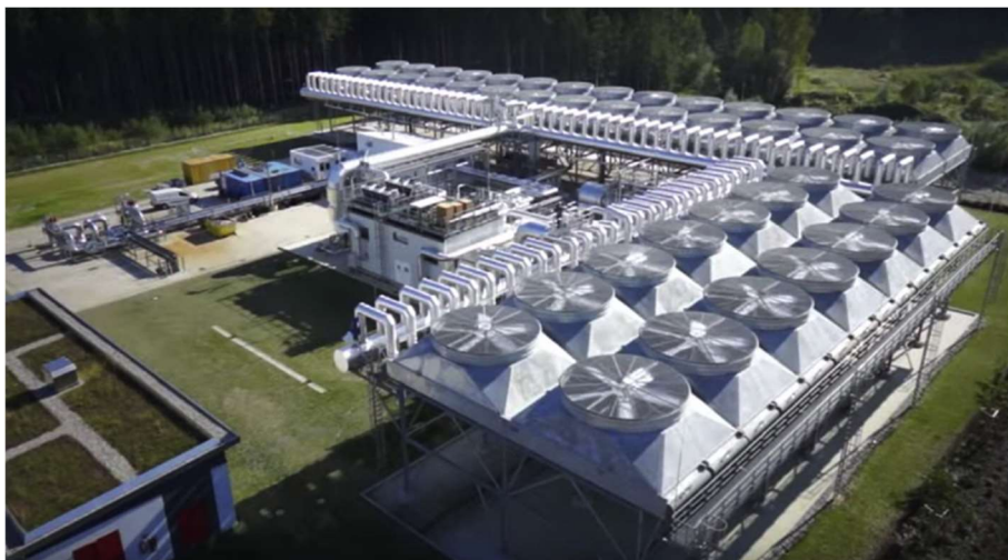
Figura 14 – ORC geotérmico de 5,6 MW (Turboden).
