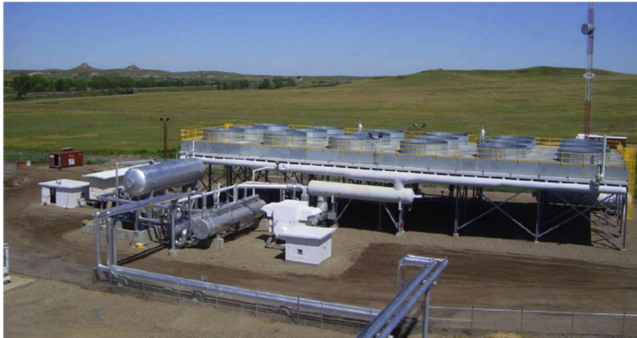
Figura 13 – ORC de 6,5 MW para compressores (Ormat).
