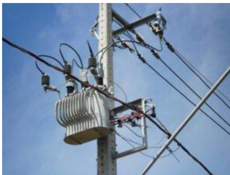
Figura 2: Rede de distribuição aérea
