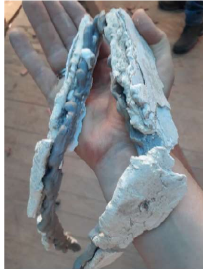
Figura 14 - Material encontrado na alvenaria.
