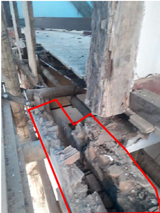
Figura 15– Parede com caco tijolo no reboco 3
