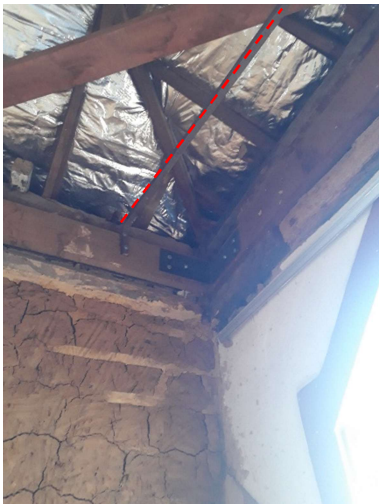
Figura 29 – Barra de ferro existente no telhado
