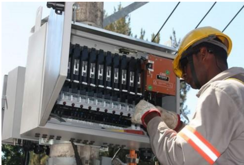
Figura 14 – Sistema de Distribuição de Medição de Energia Elétrica (SDMEE)
