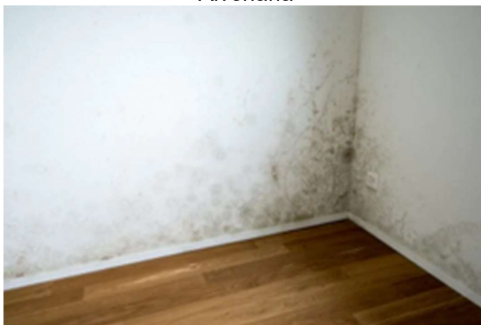
Figura 5 - Manifestação Típica de Umidade Ascendente por Capilaridade em Alvenaria
