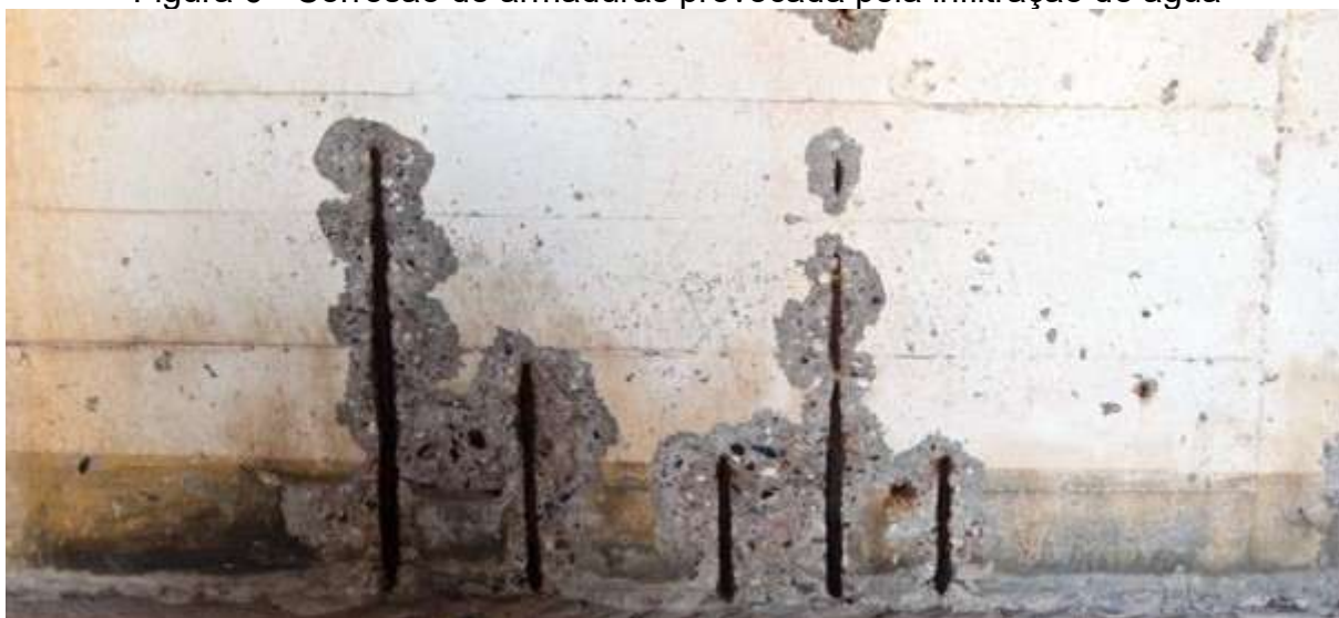
Figura 6 - Corrosão de armaduras provocada pela infiltração de água
