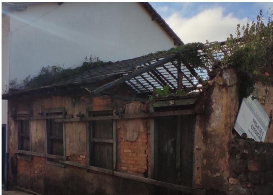
Figura 09: Situação do imóvel localizado na rua Maciel, nº 246, em 2022. Disponível em: Acervo particular. Data: 13 de Mar. de 2022.
