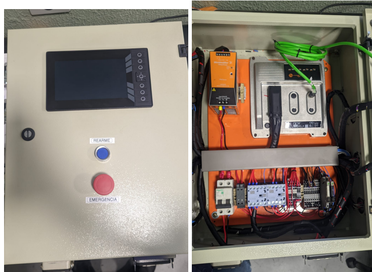
Figura 33 – Painel elétrico/comando principal.
