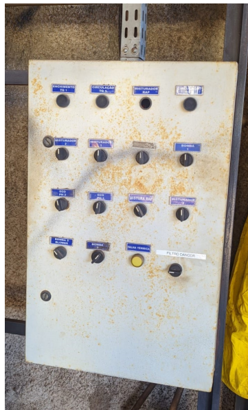
Figura 9 – Painel de elétrico/comando.
