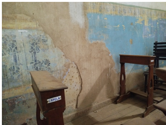
Figuras 73 e 74 – Parede lateral interna com desprendimento de reboco e parede interna ao lado da porta, descascamento da pintura.
