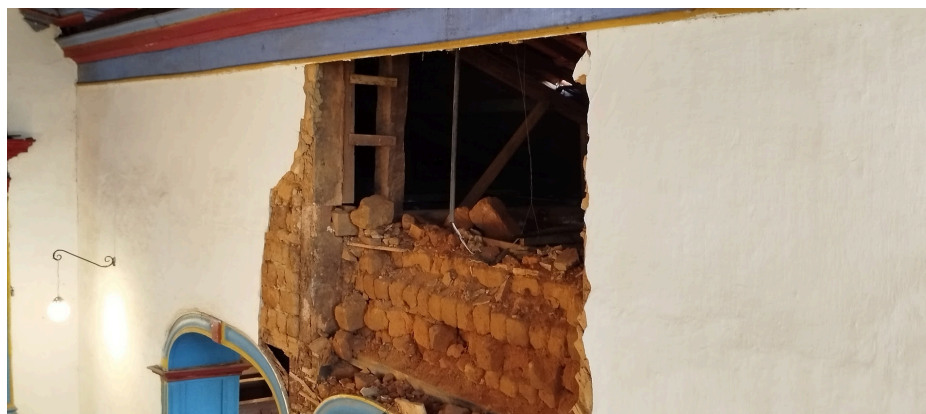
Figura 59- Parede lateral interna da Capela com colapso de adobe.
