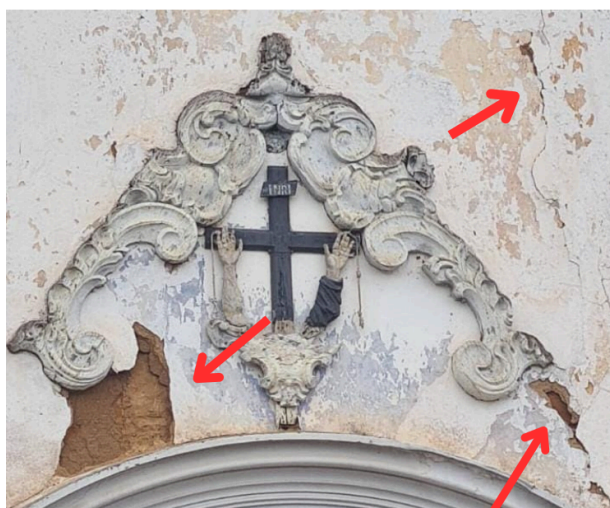
Figura 83- Desprendimento do reboco em volta do emblema de São Francisco.
