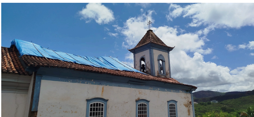
Figura 88- Telhado lateral da Capela Rainha dos Anjos coberto por lona azul.
