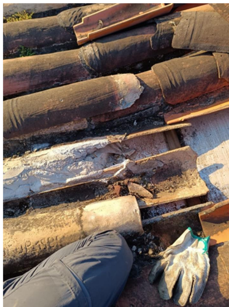
Figura 70-Telhado da Capela da Boa Morte com excesso de argamassa.
